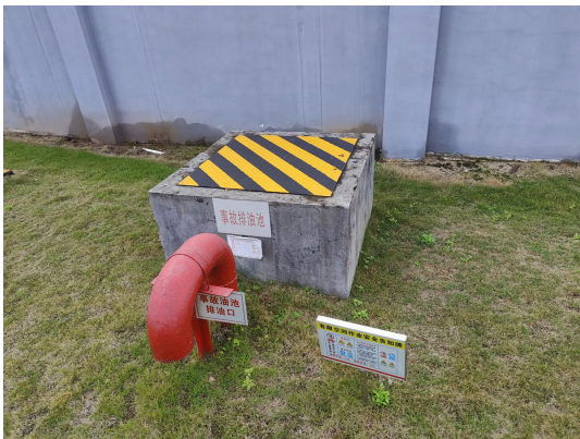
现有事故油池
