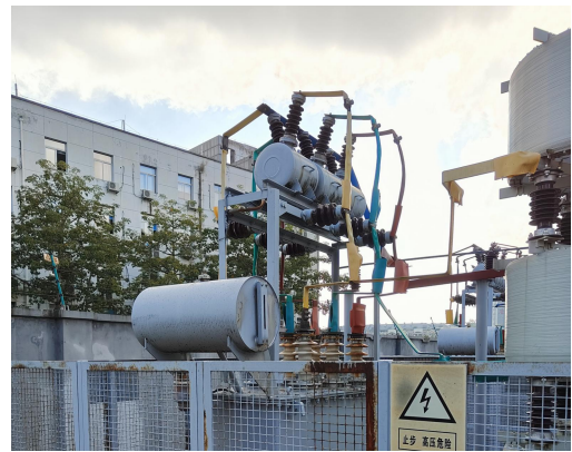
10kV 电容器组
