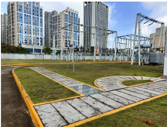
110kV 配电装置区
