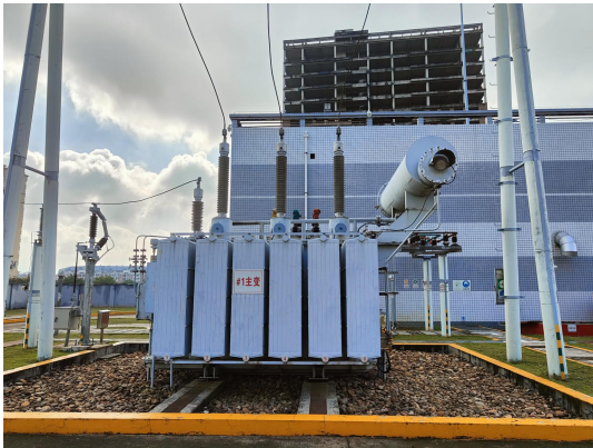
现有 1 号主变 (31.5MVA)
