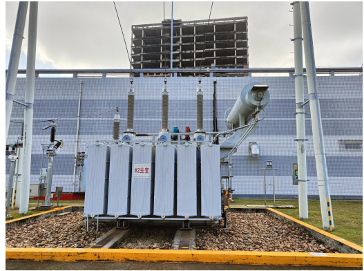
现有 2 号主变 (31.5MVA)
