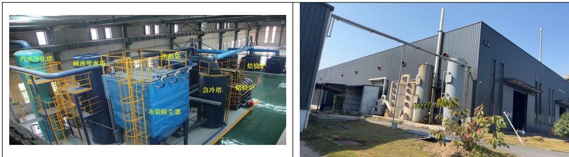
25#厂房回转窑炉废气治理设施 (DA001)
